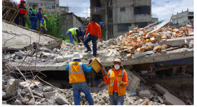
Görsel 1.3.2: Deprem sonucu yıkılmış bina
